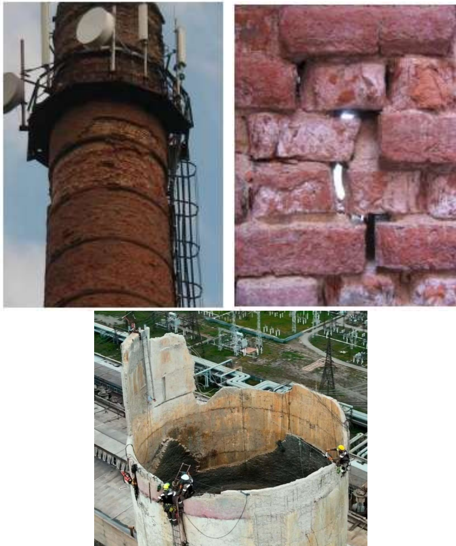
Рис. 1.3. Характерні дефекти димових труб.
