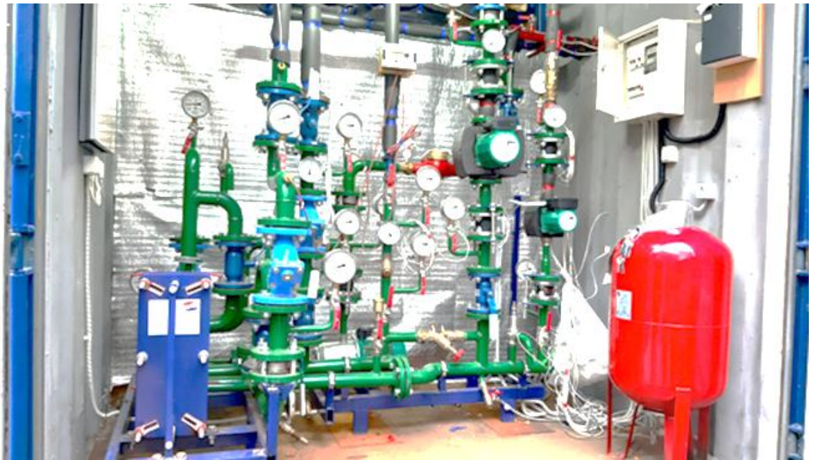
Рис. 7.2.4. Гідравлічна секція. Фото індивідуального теплового пункту МТА-0,5МВт: а) процес комплектації ІТП; б) робочий стан ІТП
