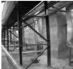
Теплоутилізатор УТНП-0,7 м. Чернігів
