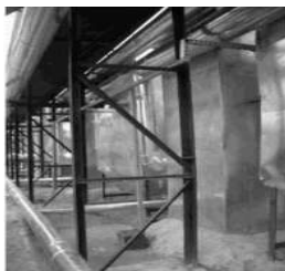
Теплоутилізатор УТНП-0,7 м. Чернівців
