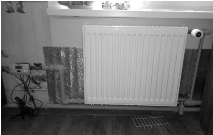
Рис. 7. Фрагмент установки квартирнього приладу обліку споживання теплової енергії, нового нагрівального приладу і регулятора температури.
