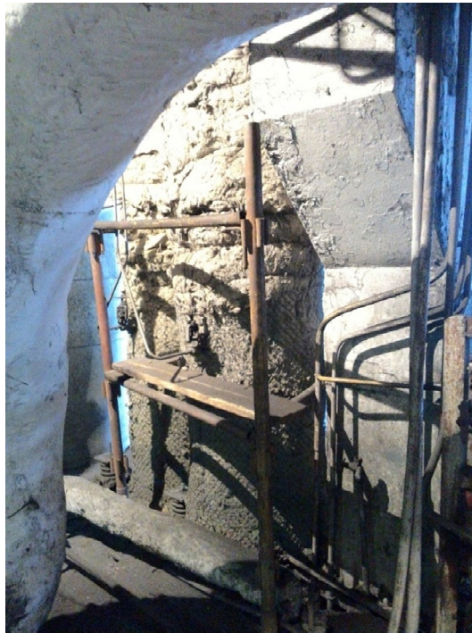
Рисунок 6. 12 - Зразок 2, МТПБа 30 (праворуч), зразок 3, ТЕХ МАТ (ліворуч), паропроводи гарячого ПП, відм. +9,6 м.
